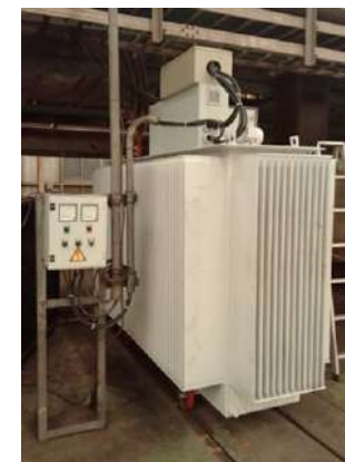
APL電解段NO.4整流變壓器 汰舊換新
